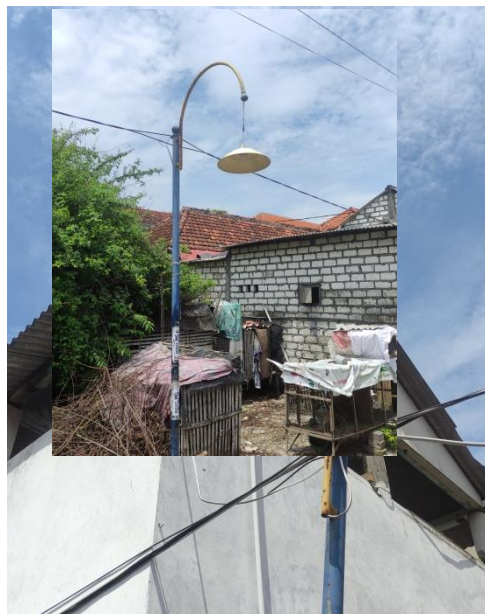
Gambar 2 : kondisi instalasi lampu jalan
