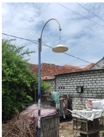
Gambar 1 : kondisi instalasi lampu jalan
