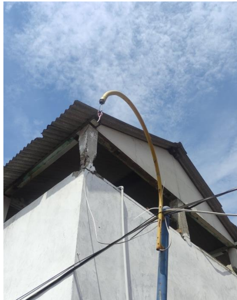
Gambar 2 : kondisi instalasi lampu jalan
