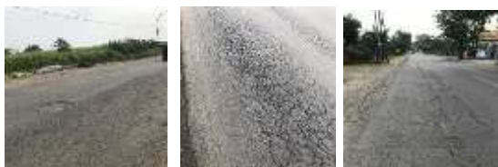
Gambar 5. Kerusakan Jalan Morowudi Kabupaten Gresik
