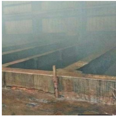
Gambar 5. Limbah asam pickling pada bak pickling
