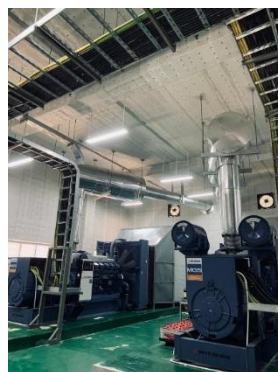
Gambar 1. Tata letak genset dan panel sinkronisasi pada proyek DKUT PK-19
