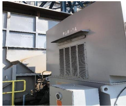
Gambar 2. Primary Air Fan
