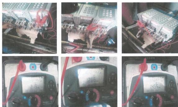
Gambar 3. Dokumentasi Pengujian Megger 1025
